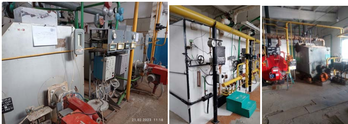
а) котельная в станции Вознесенская (МУП г. Лабинска «Тепловые сети»); б) котельная в хуторе Первая Синюха (МУП г. Лабинска «Тепловые сети»); в) котельная в г. Лабинске (АК-1197)
